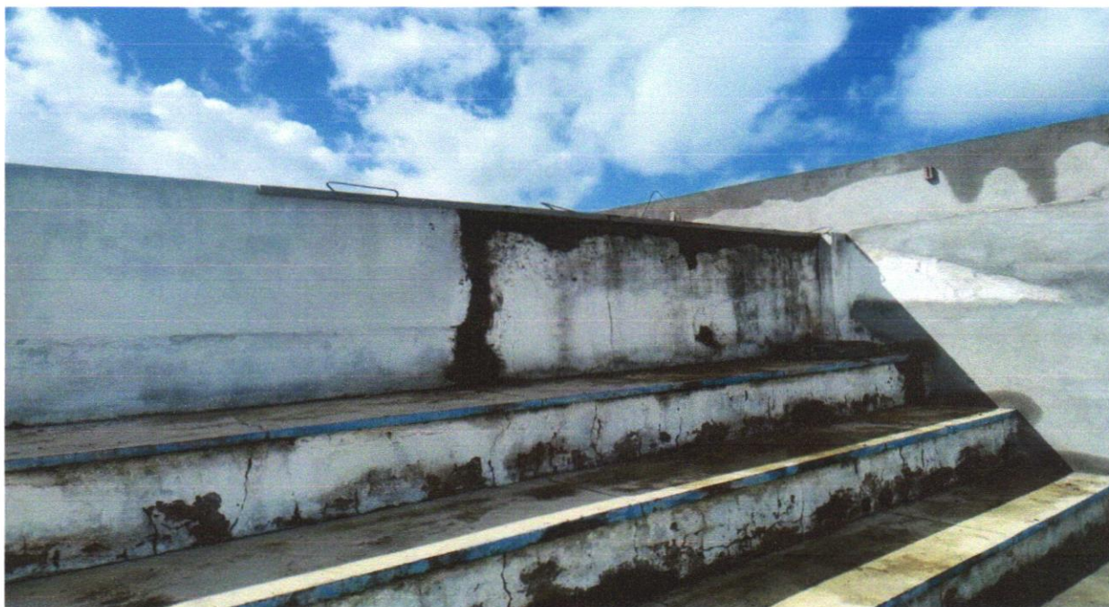
FOTO 23 - Tratamento de fissuras com argamassa industrializada massa rápida Rebotec ou similar (Seção até 5 x 5 cm)
